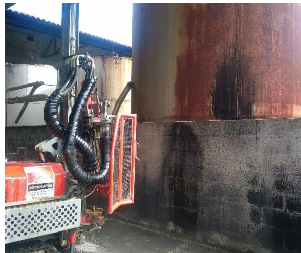
Photo 6 : Anciennes cuve aérienne de fioul lourd + cuves aériennes de graisses. Prélèvement S3
